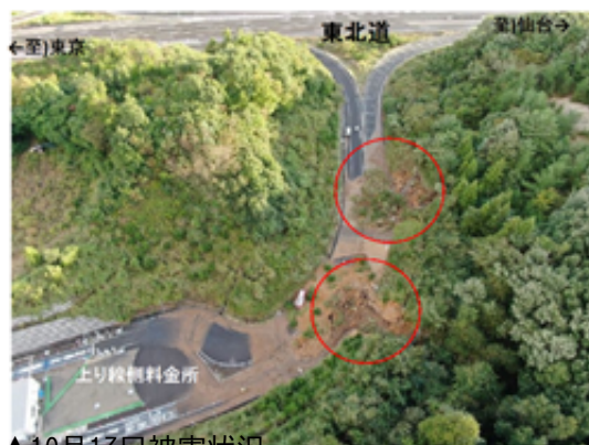
▲10月13日被害状況
