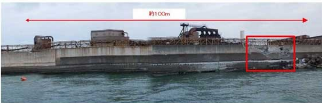
写真3 護岸の損傷状況
