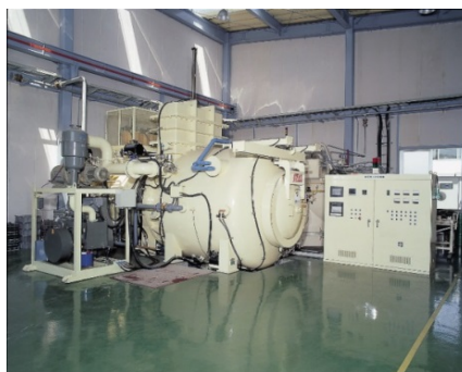
清水電設の真空焼入炉
